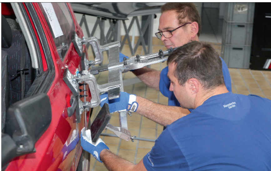
Die ein- bis zweitägigen Miracle-Schulungen beginnen im Theorieteil mit Werkstoffkunde, Schadensbeispielen und Erläuterungen zu Einsatz und Anwendung der Miracle-Komponenten, bevor die Teilnehmer unter Anleitung selbst Hand anlegen.
